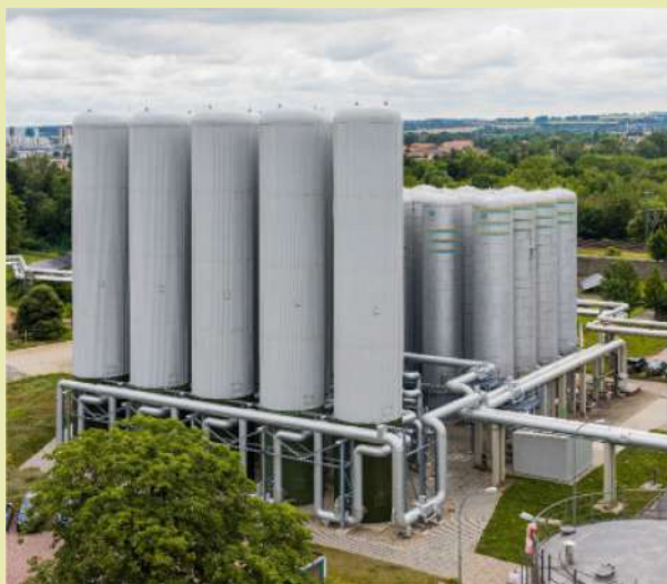
Stoccaggio termico presso la centrale elettrica innovativa Reick, SachsenEnergie, Killig 2021.
